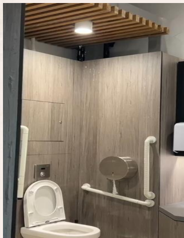
洗手間水箱滲水
